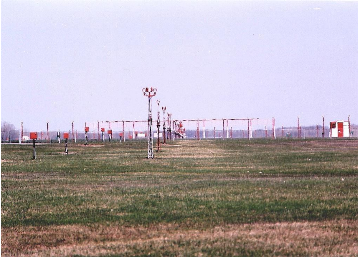
Hình 4-4. Cột đèn tiếp cận - cấu trúc nhôm
