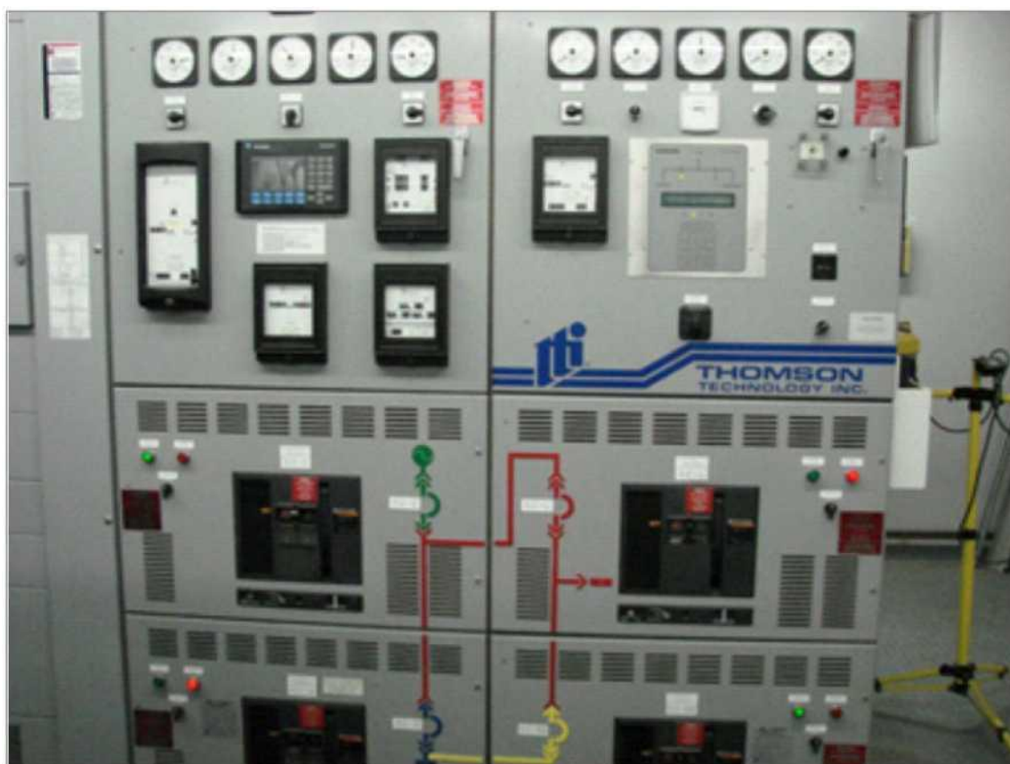
Hình 3-8. Tủ thiết bị chuyển đổi nguồn (nguồn: Toronto International Airport)
