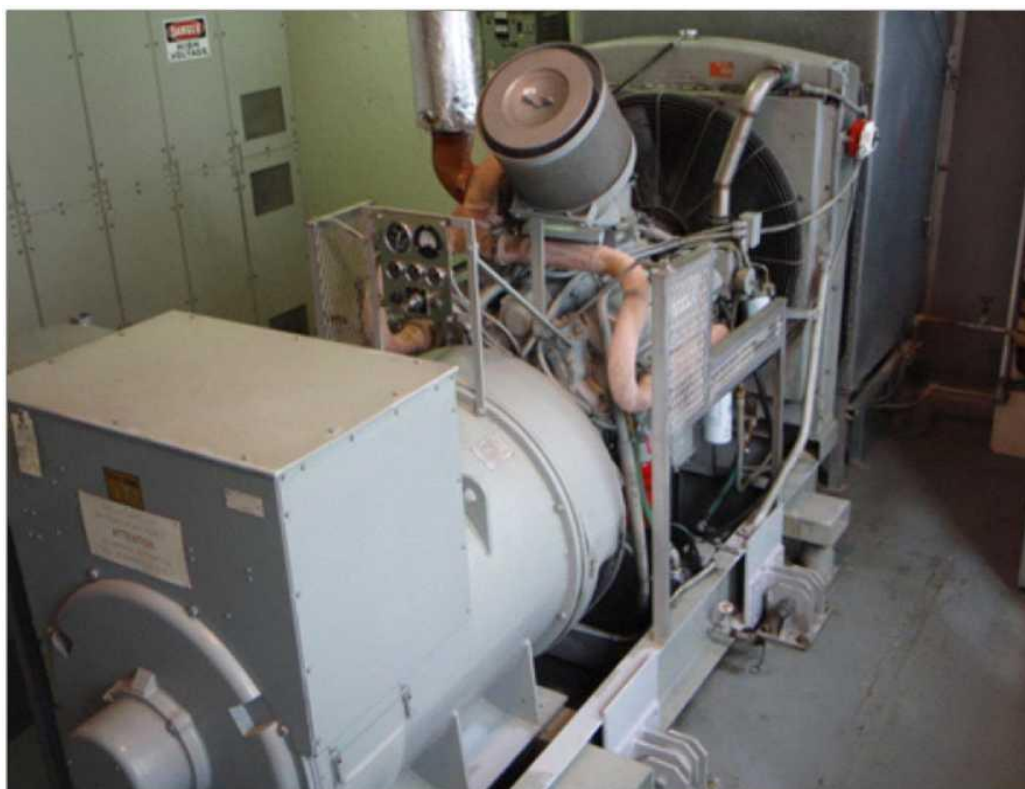
Hình 3-7. Tổ máy phát điện-diesel (nguồn: Toronto International Airport)
