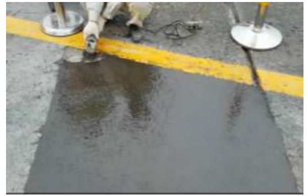
(b) Mài lớp ô xy hóa bề mặt cho đồng màu với bê tông cũ
