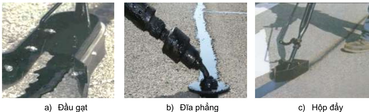
Hình 2 - Trám nhựa lên mặt khe nứt
