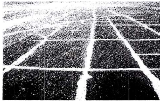
Hình A.13 – Nứt hình khối có mastic hư hỏng nhẹ
