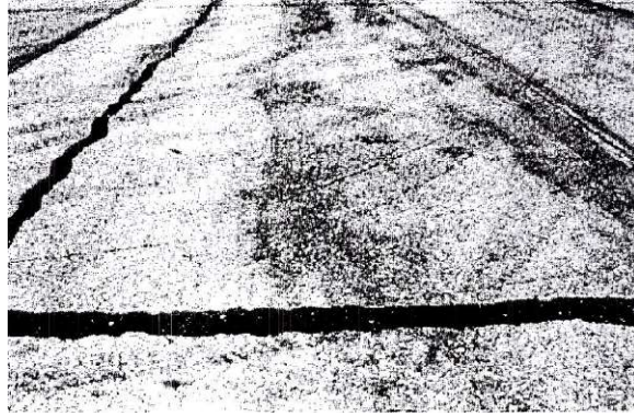
Hình A.31 – Nứt phản ánh khe có mastic hư hỏng nhẹ
