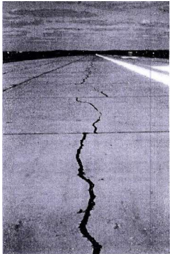
Hình B.12 – Nứt dọc được chèn hư hỏng trung bình
