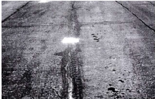
Hình A.40 – Nứt dọc hư hỏng trung bình (Chú ý là nứt phản ánh nhưng không ở khe tẩm)
