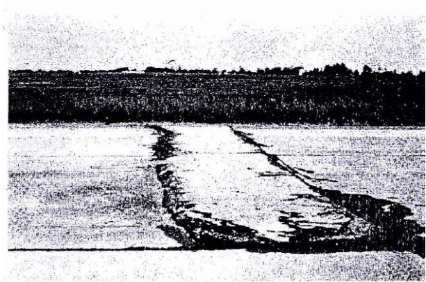
Hình B.2 – Phá hủy do giãn nở hư hỏng trung bình
